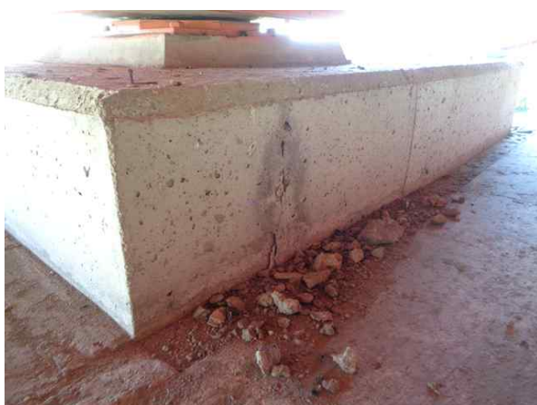
P35-Sh1 받침콘크리트 파손 (0.1m×0.3m×2EA)
