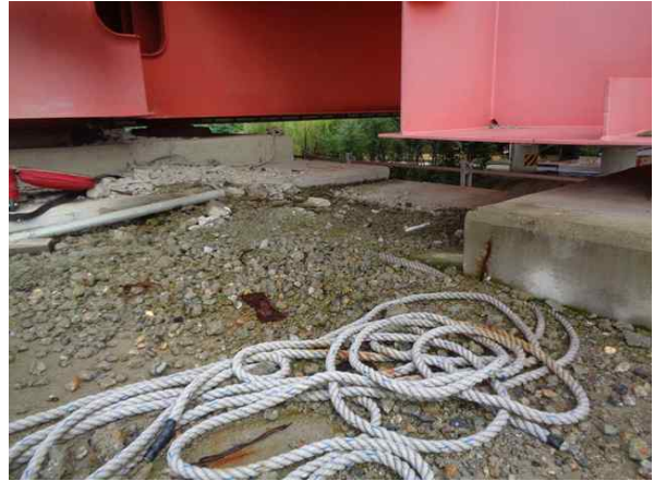
P2 코핑부 상면 폐코크리트 적치
