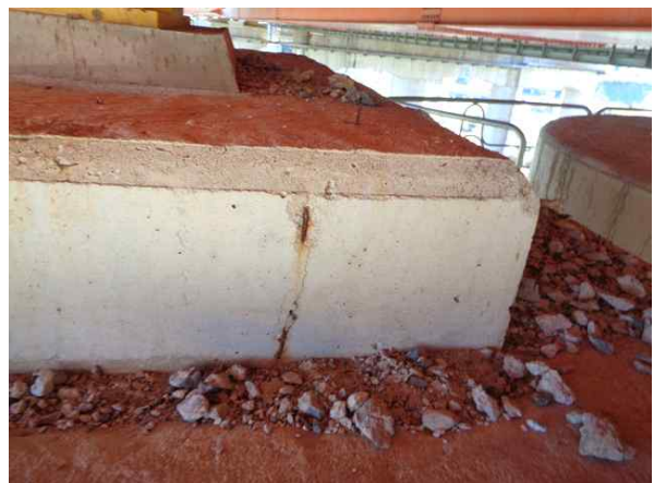
P1-Sh1 받침콘크리트 파손 (0.1m×0.3m)
