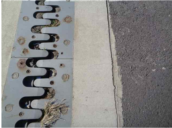
A2 후타재 균열 (0.2mm/0.3m×10EA)
