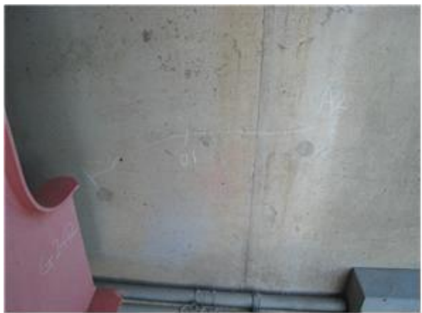
A2 균열(폭 0.2mm/1.0m)
