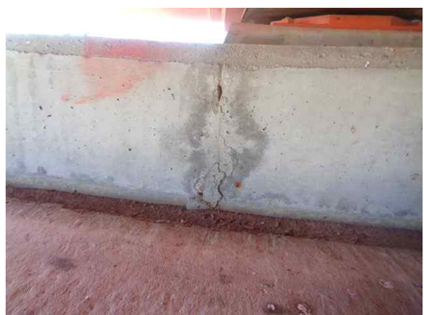
P35-Sh1 받침콘크리트 파손 (0.1m×0.3m×2EA)
